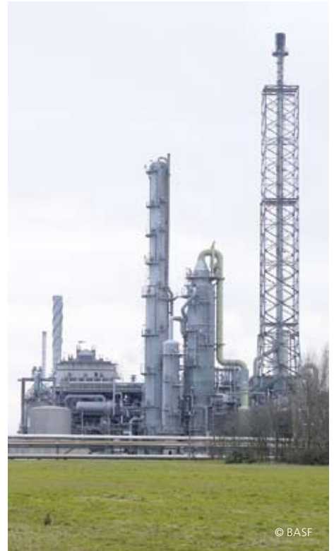
Ammoniakanlage der Firma BASF
