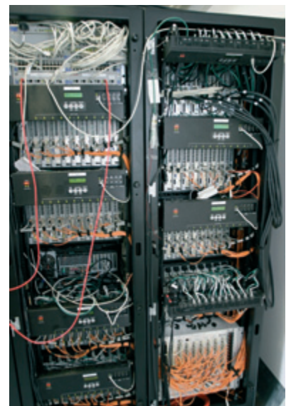
Serverraum: Rückseite der Server mit den unterschiedlichsten Kabeln
